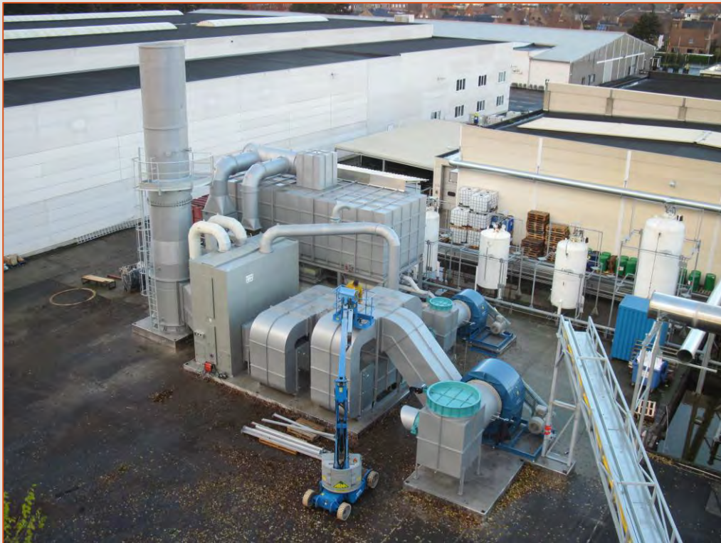
Ossidatore termico rigenerativo (RTO) a tre camere con sistema di preconcentrazione fumi tramite rotoconcentratore - Tielt (Belgio)
