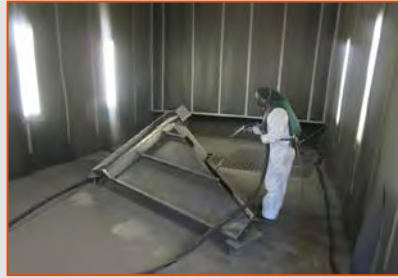
Cabina di sabbiatura e verniciatura
