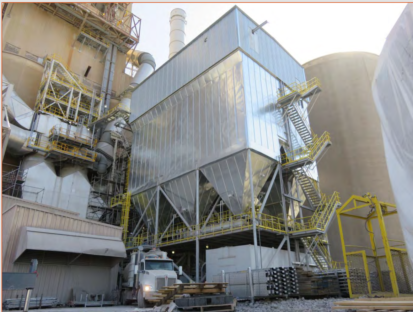
Sistema di depolverazione per cementificio con filtro a maniche, impianto di produzione cemento, Cape Girardeau (MO), USA
