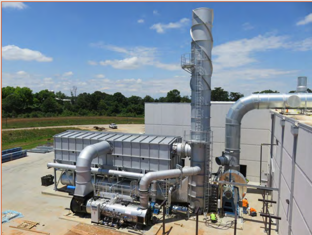
Ossidatore termico rigenerativo (RTO) a cinque camere con caldaia e sistema di recupero calore – Spartanburg, SC - USA
