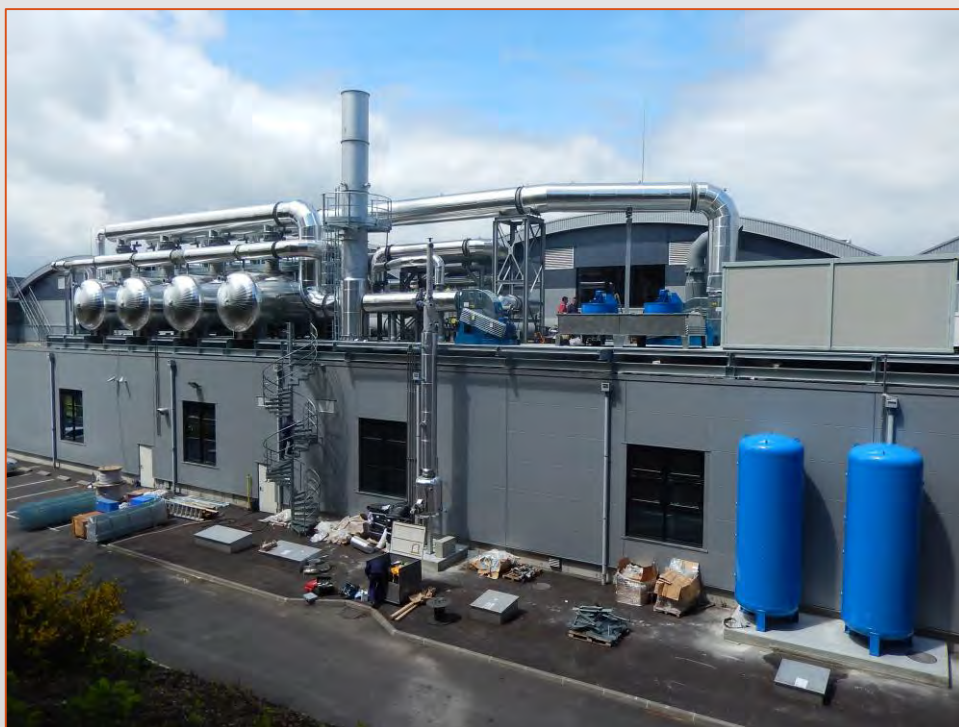
Impianto recupero solventi completo di condotti aria e rigenerazione azoto, camino, piping acciaio inox – Saint Sigolaine, Francia
